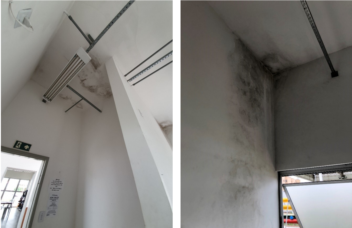
Figura 10 - Tetos com Infiltração
