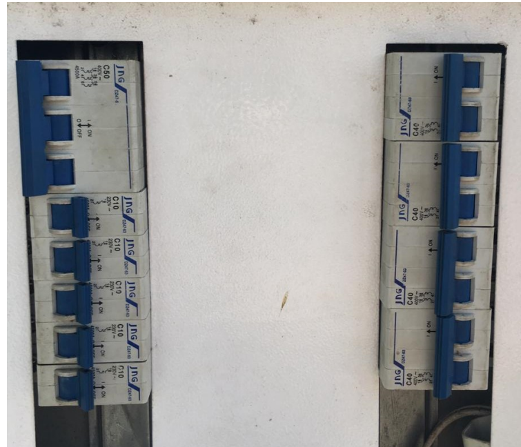
Figura 19 - Quadro de Distribuição (QD4)
